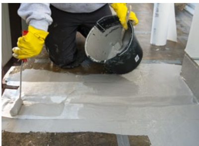
Abdichten der Dehnungsfuge in drei Schritten: PMMA-Harz vorlegen, Vlies blasenfrei einarbeiten und mit Harz sättigen.
