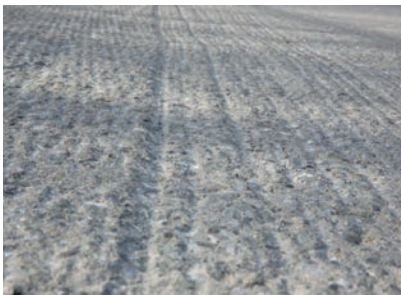
Der Betonuntergrund wies erhöhte Rautiefen > 1,5 mm auf, Ausbrüche fanden sich zum Teil bis zu den Bewehrungen.
